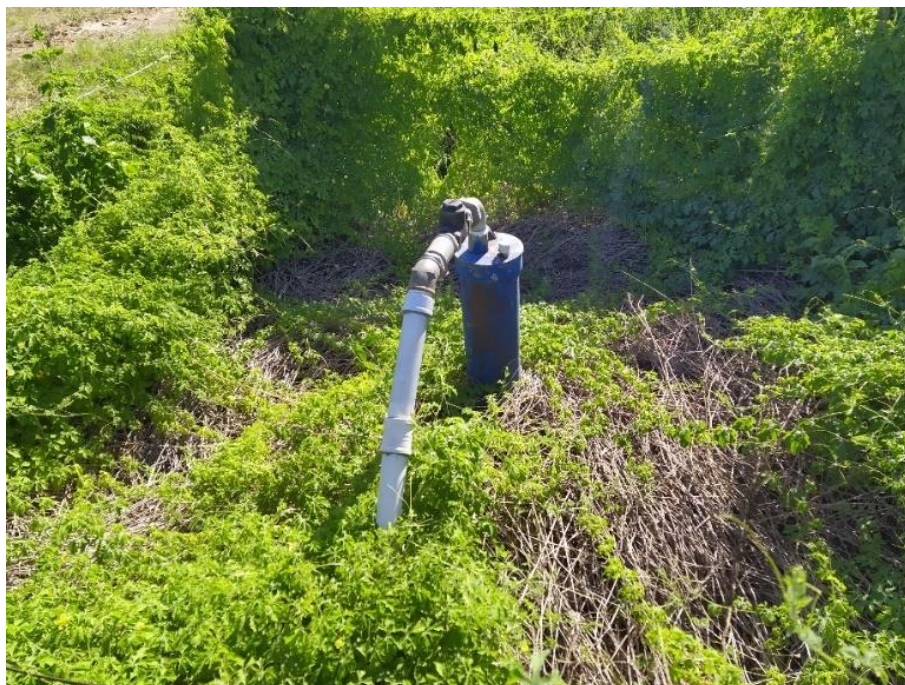
Figura 66: Captação d'água na Fazenda Aparecida.
